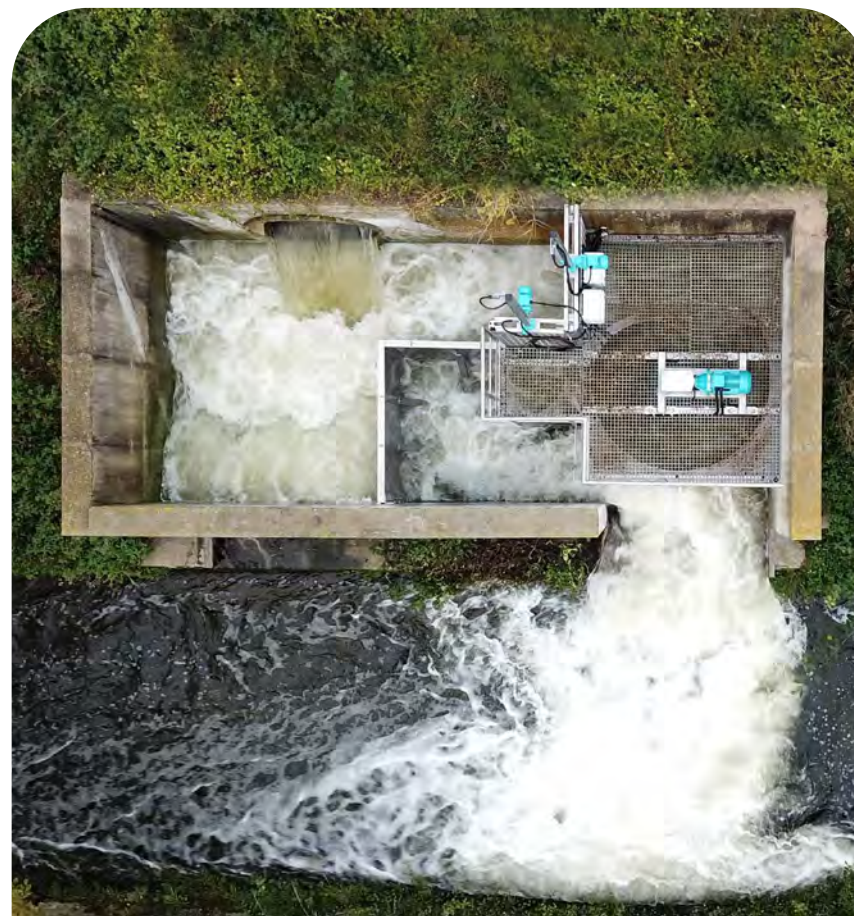
Een Turbulent-installatie in Versailles, Frankrijk.
