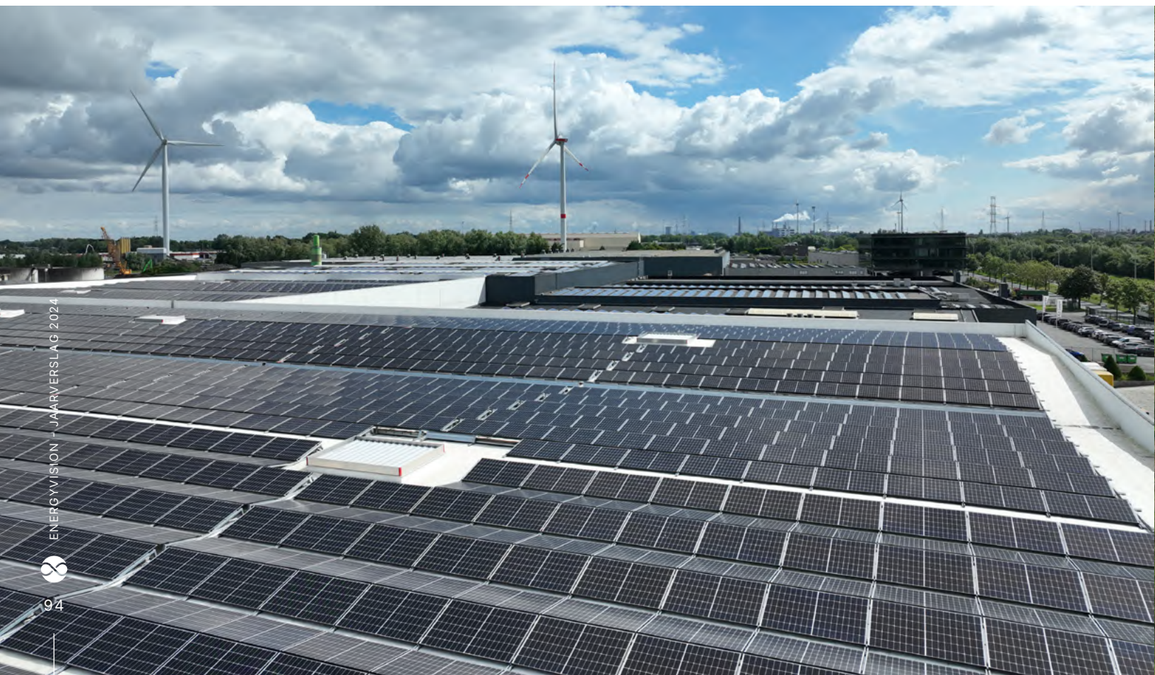
✓ Zonne-installatie met 3.790 zonnepanelen op het dak van Laroy Group in Wondelgem.
